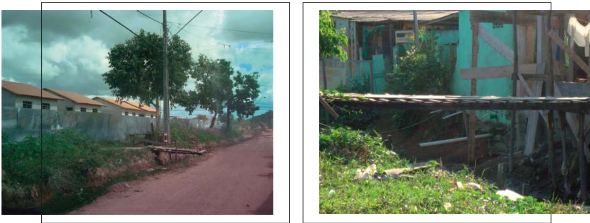
Figura 37 – Passarelas improvisadas sobre valões em Morada da Barra e Terra Vermelha 2011
