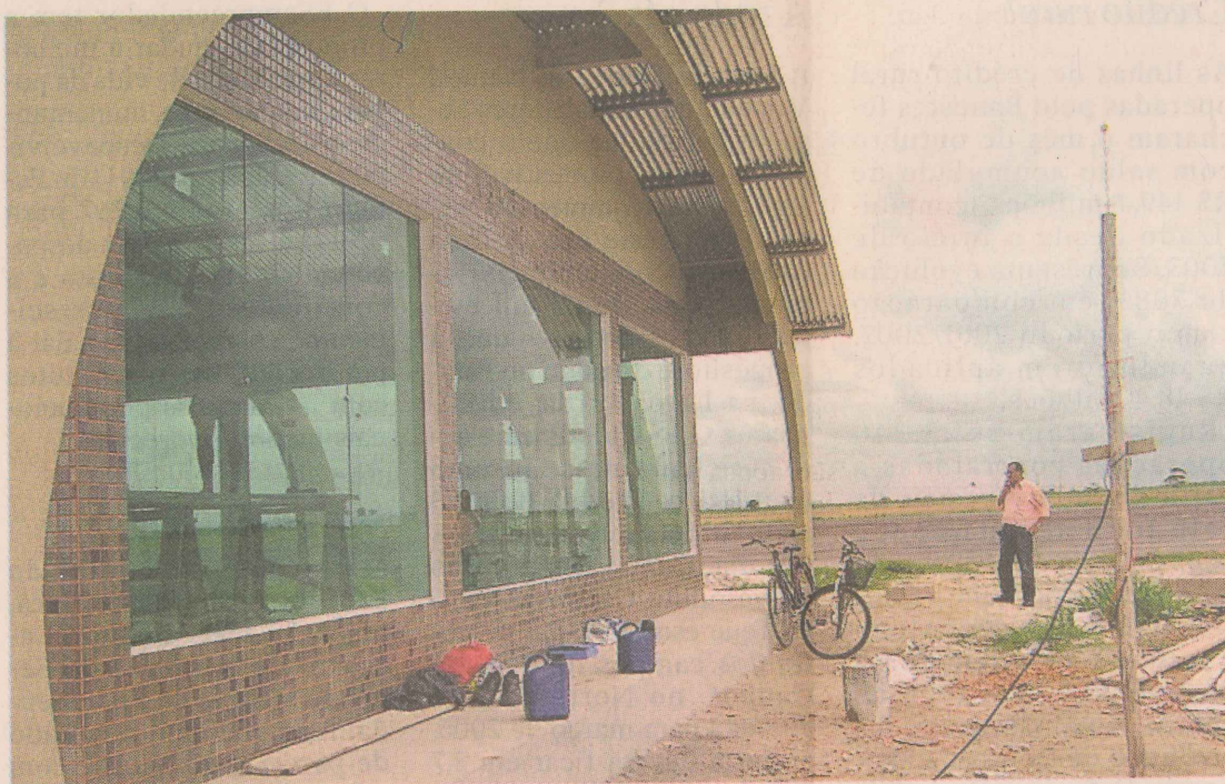
ACABAMENTO. O terminal de passageiros do aeroporto de Linhares recebe os últimos retoques para começar a operar com vôos regulares em 2006. FOTO: ZENILTON CUSTÓDIO
