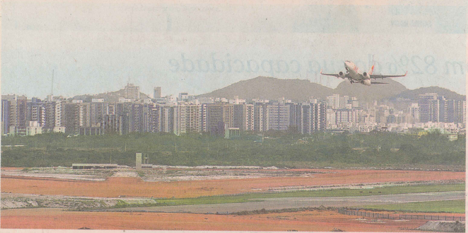
DECOLAGEM. As obras de terraplenagem das pistas – a complementação da atual e a nova pista – estão na lista de prioridades até mesmo para evitar que se perca parte do trabalho já realizado. FOTO: CHICO GUEDES
