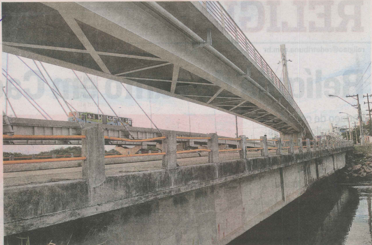
ANTIGA PONTE DA PASSAGEM, em Vitória: prazo para demolição é de oito meses após o início das obras
