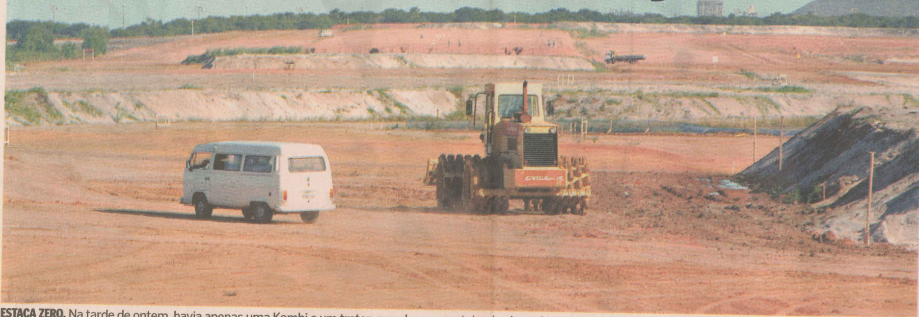
ESTACA ZERO. Na tarde de ontem, havia apenas uma Kombi e um trator, parados, no canteiro de obras do Aeroporto de Vitória. FOTO: EDSON CHAGAS
