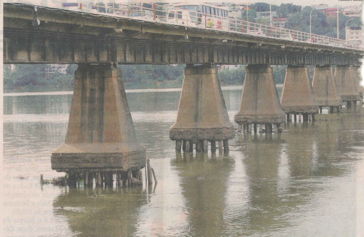
PONTE FLORENTINO AVIDOS está com a estrutura comprometida, segundo apontou inspeção de engenheiros
