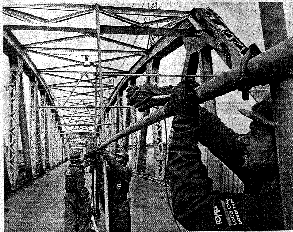
SEGURANÇA. A passarela para ciclistas e pedestres foi ampliada de 1,30 metro para 1,80 metro de largura, o que vai permitir a passagem de dois ciclistas ao mesmo tempo. FOTO: GILDO LOYOLA
