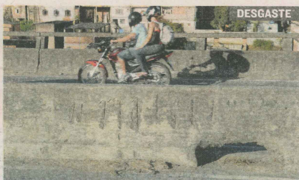
AS ESTRUTURAS METÁLICAS das divisórias das pistas estão visíveis ao longo da ponte. O desgaste atinge também os buracos de drenagem.
