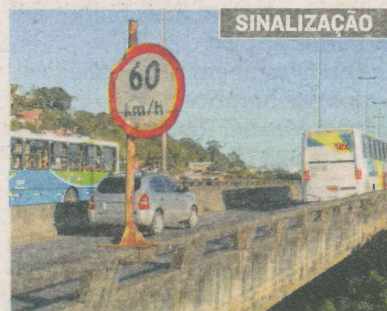
TODAS AS PLACAS de sinalização da ponte estão enferrujadas, algumas até empenadas.
