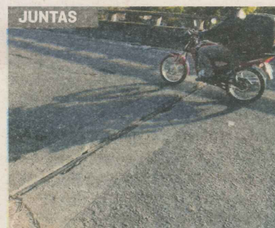
AS JUNTAS de dilatação, importantes para a estabilidade da estrutura, estão desgastadas.
