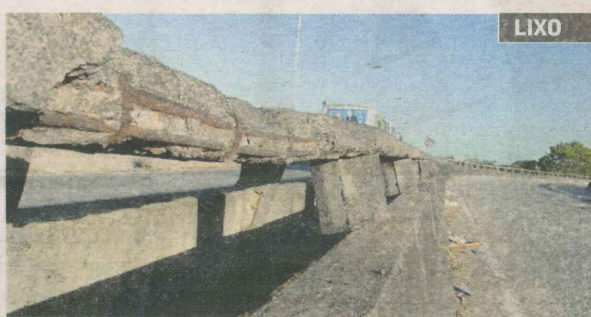
ALÉM DO DESGASTE em vários pontos dos parapeitos, há lixo acumulado nas laterais da pista, nos dois sentidos da ponte.
