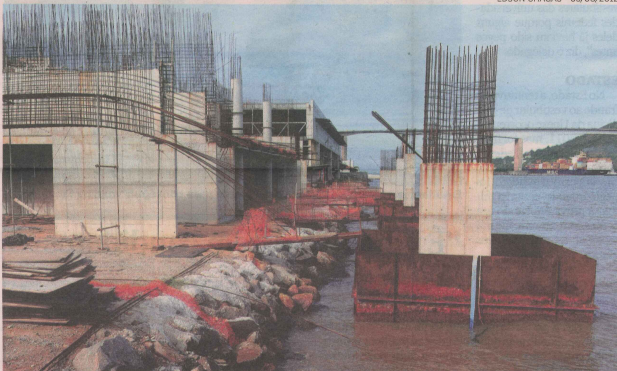
Construção está paralisada desde fevereiro, e os trabalhos deverão ser retomados em março do ano que vem
