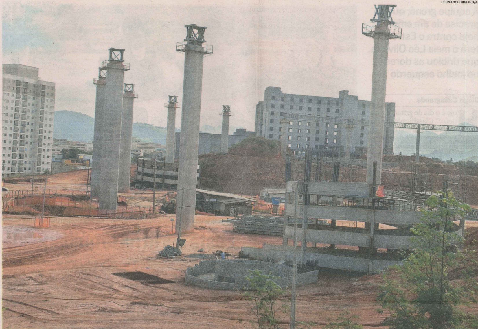
AS OBRAS DE REFORMA do estádio Kleber Andrade estão paralisadas desde maio deste ano, mas serão retomadas a partir de agosto pelo novo consórcio
