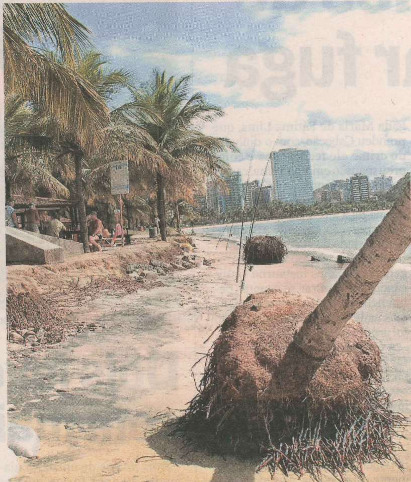
NA CURVA DA JUREMA, a erosão destrói o aterro e derruba os coqueiros
