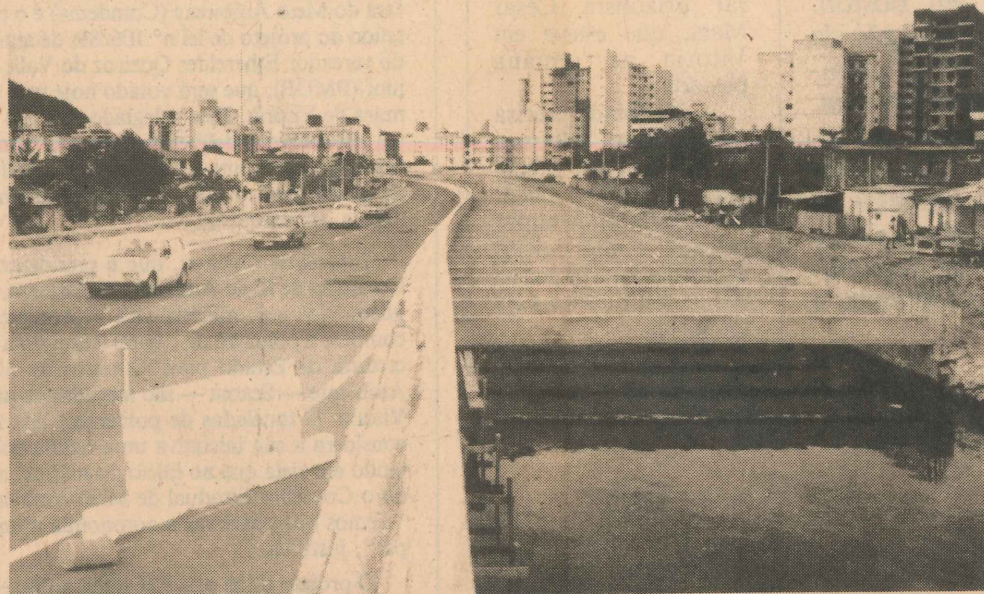
Já foram realizadas obras num trecho do Canal da Costa, mas resta uma parte
