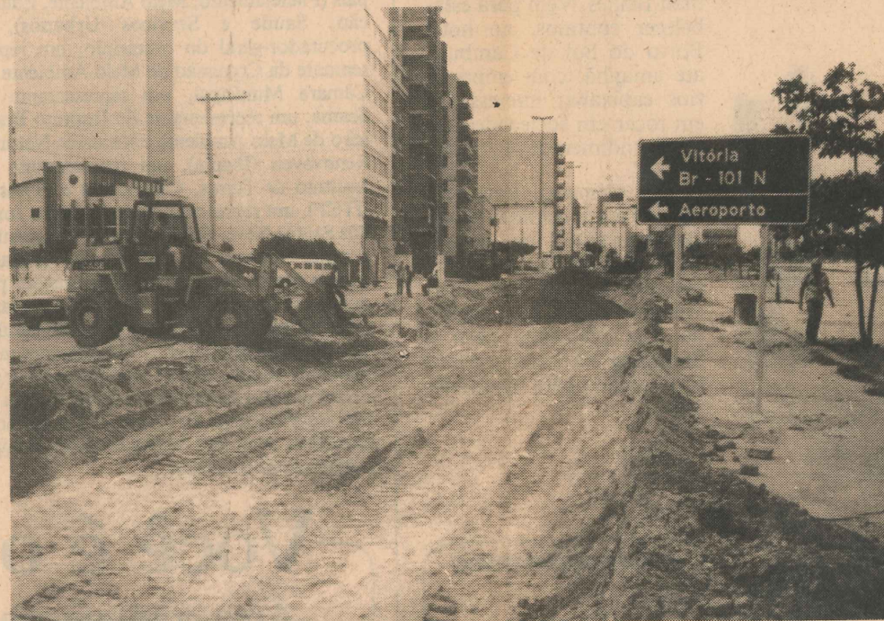
Além das defensas da ponte faltam acabamento nos acessos do lado de Vila Velha
