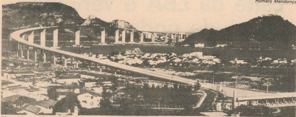
Noventa e cinco por cento das obras da Terceira Ponte já estão concluídos
