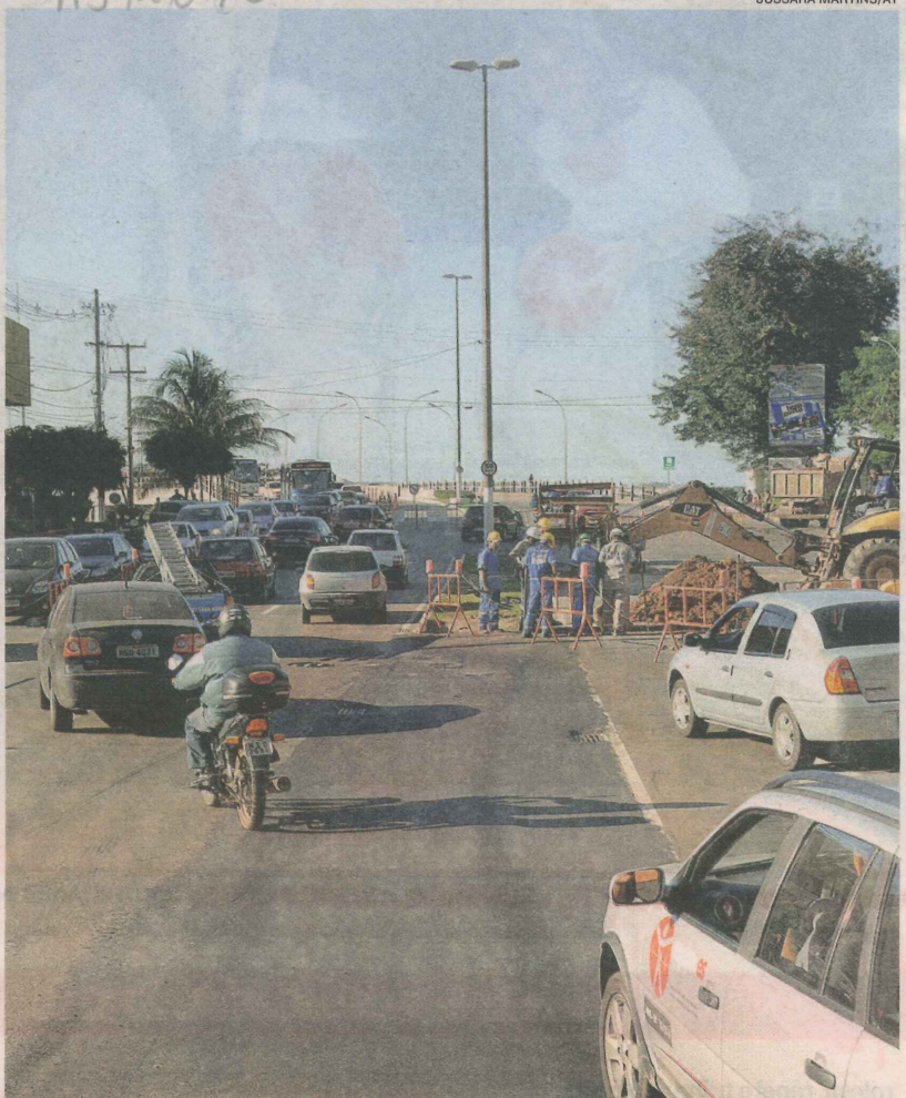
TRECHO DA AVENIDA Saturnino de Brito que está interditado
