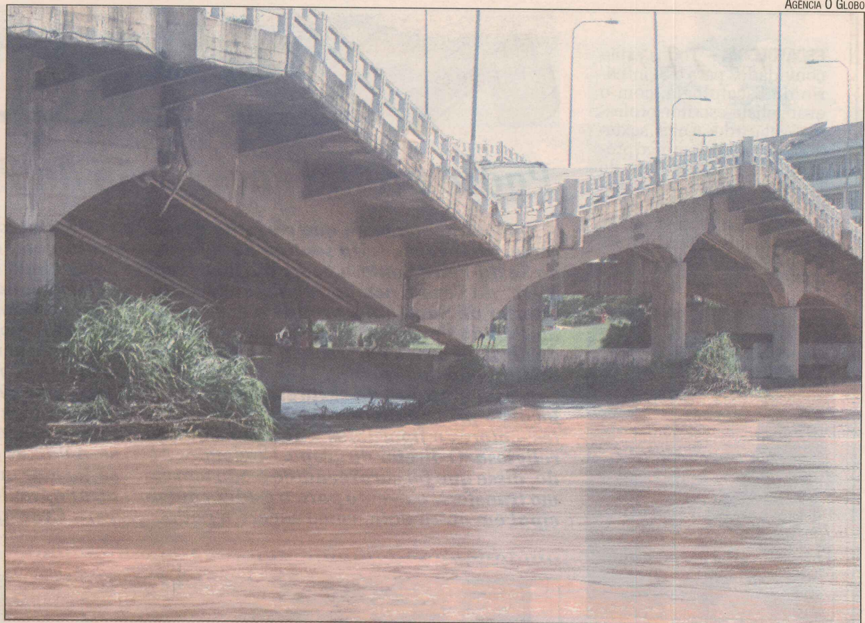
O vão central da ponte General Dutra desabou devido à força das águas do rio Paraíba do Sul
