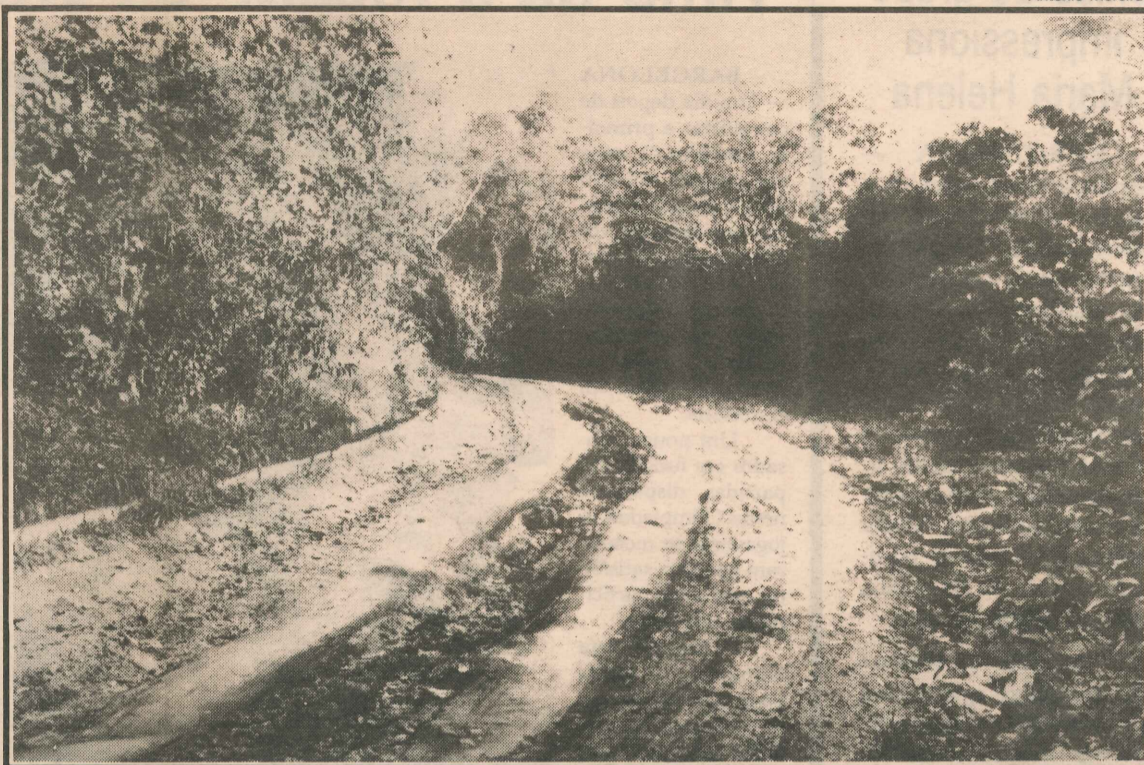
A estrada de acesso ao topo do parque não tem calçamento e fica intransitável quando chove
