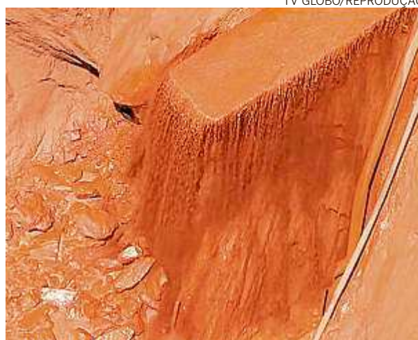
Vazamentos de lama ainda acontecem na barragem
