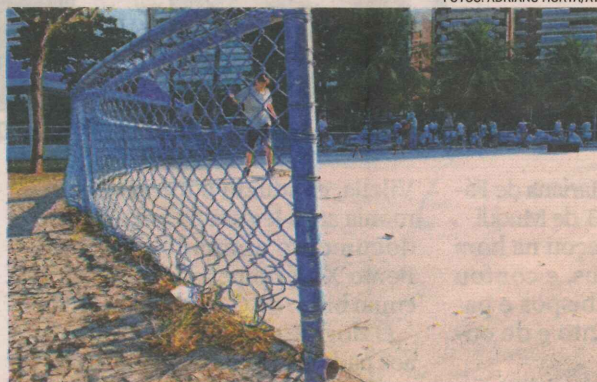
NA PRAÇA DOS NAMORADOS , na Praia do Canto, em Vitória, as pistas de patinação estão cheias de buracos e os alambrados estão quebrados.
