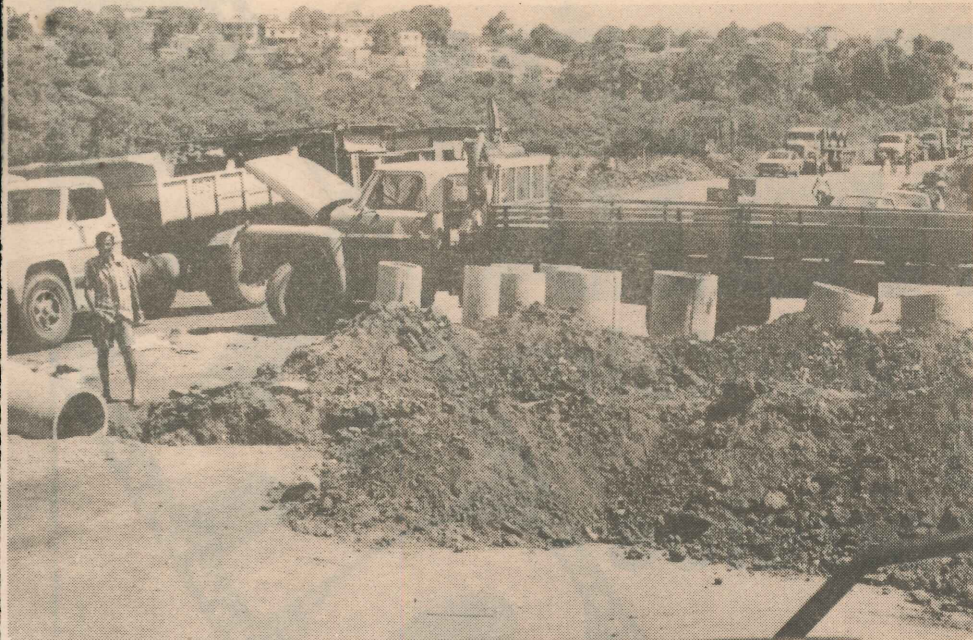
A Prefeitura de Vila Velha reabriu uma vala na estrada de acesso ao cais
