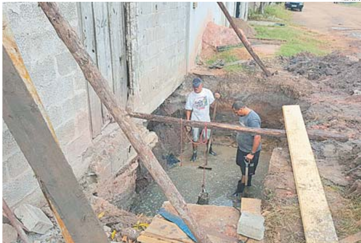
FOSSA em construção na rua Gaivotas, em São Conrado, Vila Velha, por falta de esgotamento sanitário no bairro
