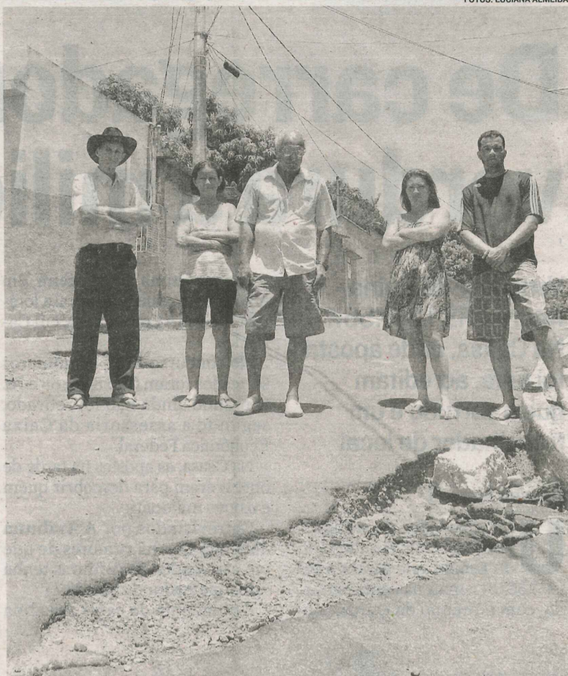
MORADORES mostram buraco no meio da ladeira em Rosa da Penha
