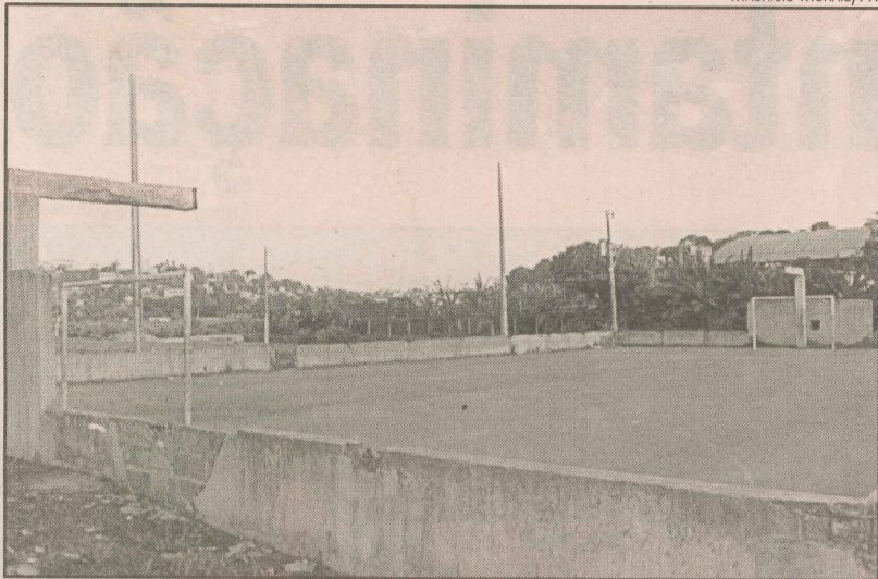
Rachaduras na quadra de esportes de São Conrado
