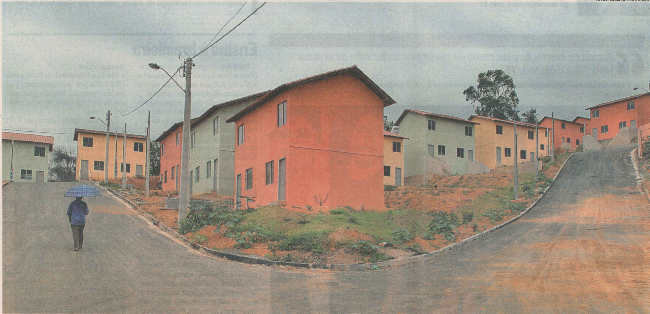
CASAS DO RESIDENCIAL VILA OÁSIS já estão até pintadas. Condomínio tem postes e padrões de energia, mas as obras ainda estão inacabadas e alguns dos futuros moradores já desistiram
