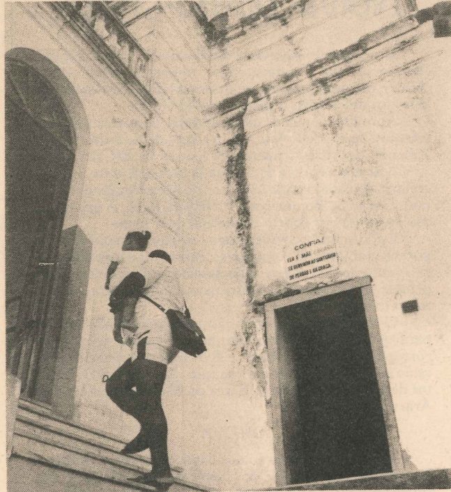
Muitas paredes apresentam rachaduras e reboco caindo
