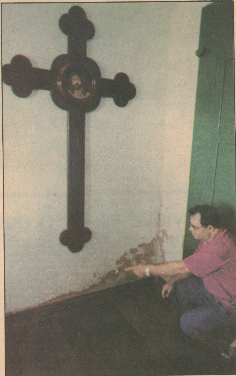
Diversas paredes internas estão com a pintura descascando e sem reboco
