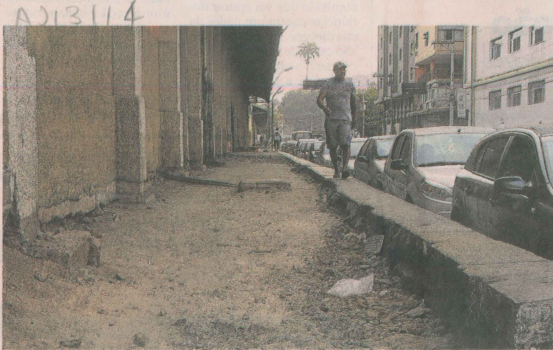
SEM ESTRUTURA. Em alguns pontos, calçada foi totalmente retirada, e pedestre passa pela borda
