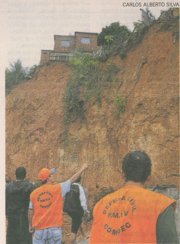
RISCO. Após deslizamento de barreira, casa à beira de um barranco no bairro Alecrim foi condenada pela Defesa Civil
