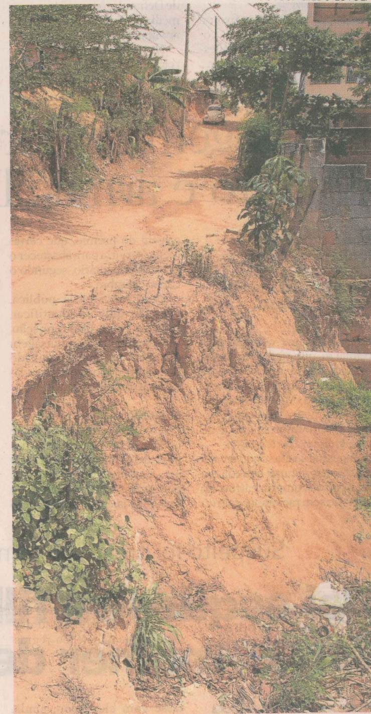
RISCO. Na Rua 12 de Outubro, o solo se desmancha a cada chuva e faz a via ceder. As casas da rua abaixo correm risco
