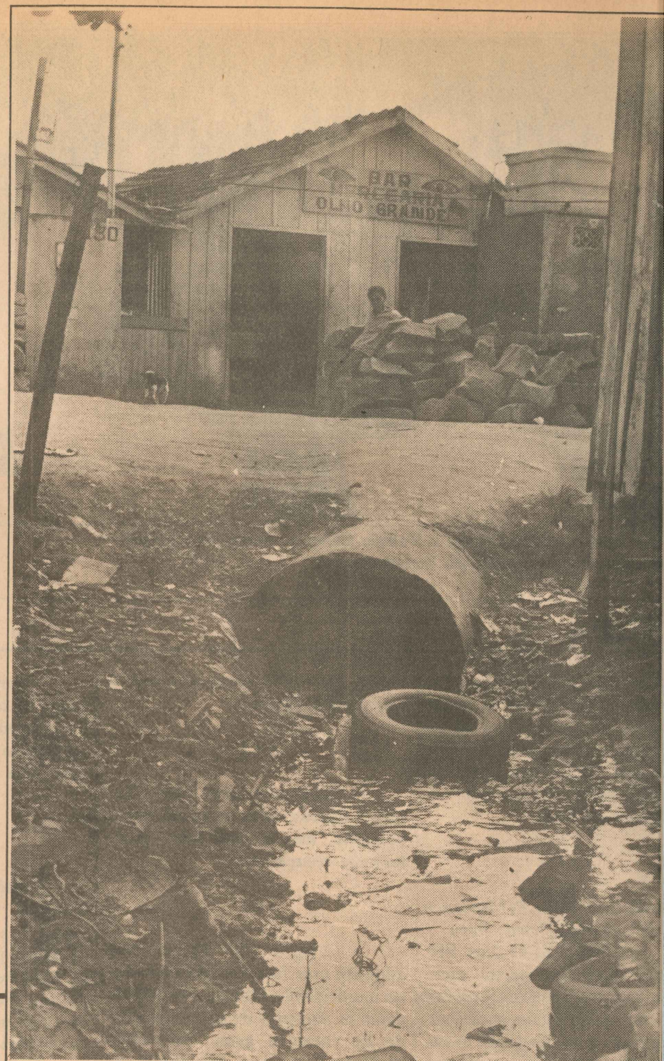
Em Andorinhas, dezenas de casas dentro de esgotos
