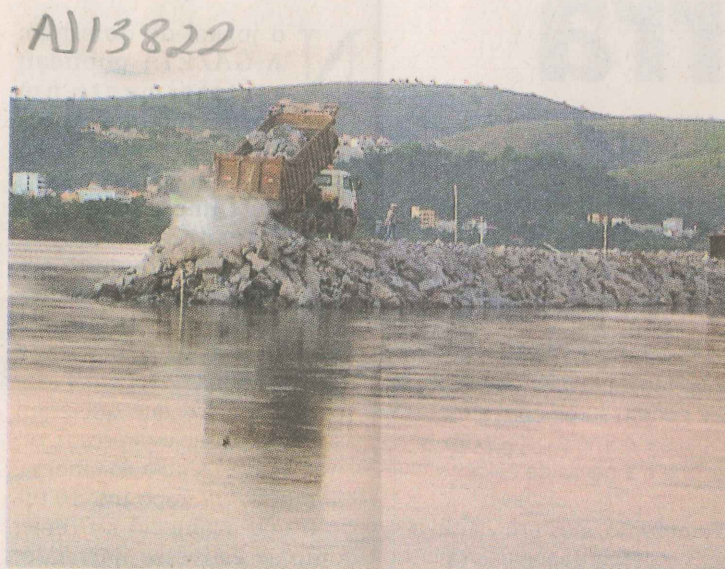
MURALHA. O muro de pedra bruta avança cerca de 20 metros por dia, à medida que caminhões aceleraram o serviço. FOTO: NILO TARDIN
