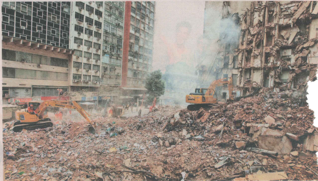
OS PRÉDIOS se transformaram em uma montanha de mais de 15 metros de altura de concreto e ferros retorcidos
