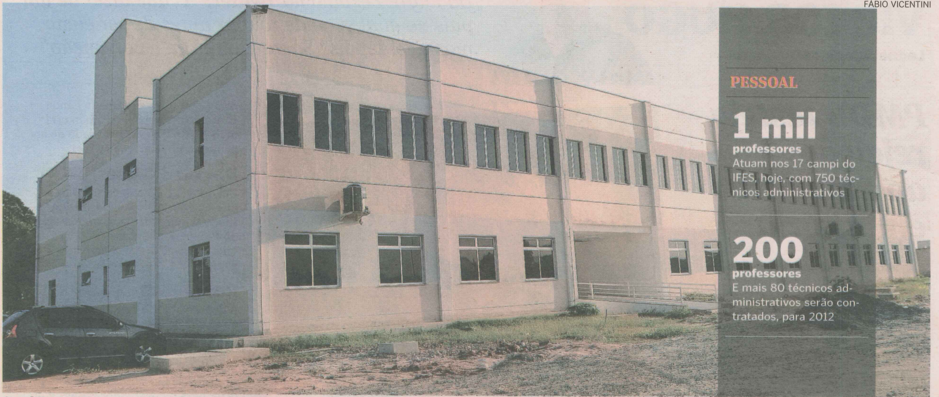
O prédio do campus de Vila Velha foi inaugurado em novembro de 2010, mas ainda não foi concluído e dá sinais de abandono. Os alunos têm aula em Vitória
