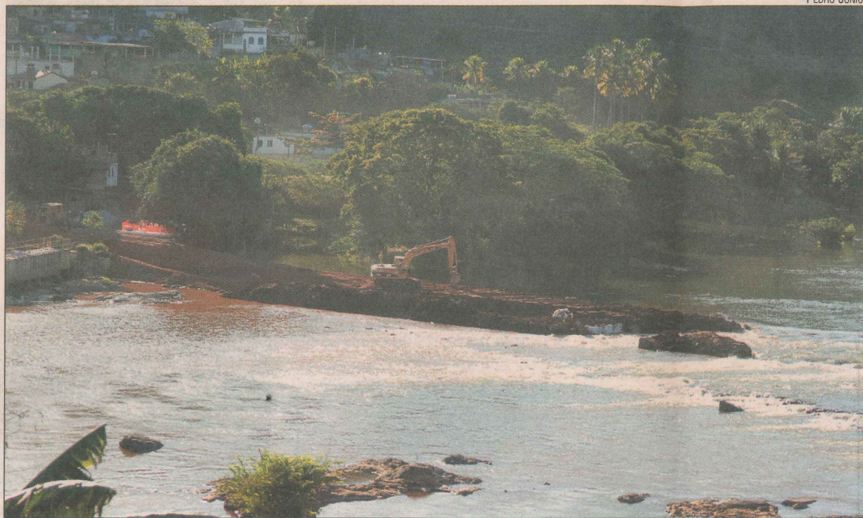
Obra permite passagem de tubulação sobre o Itapemirim: rio vai voltar ao normal após intervenções
