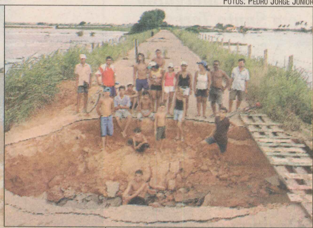
Na rodovia ES-487, que liga Itapemirim à BR-101, a força das águas arrastou parte da estrada. Em outro trecho, uma enorme cratera se abriu no asfalto
