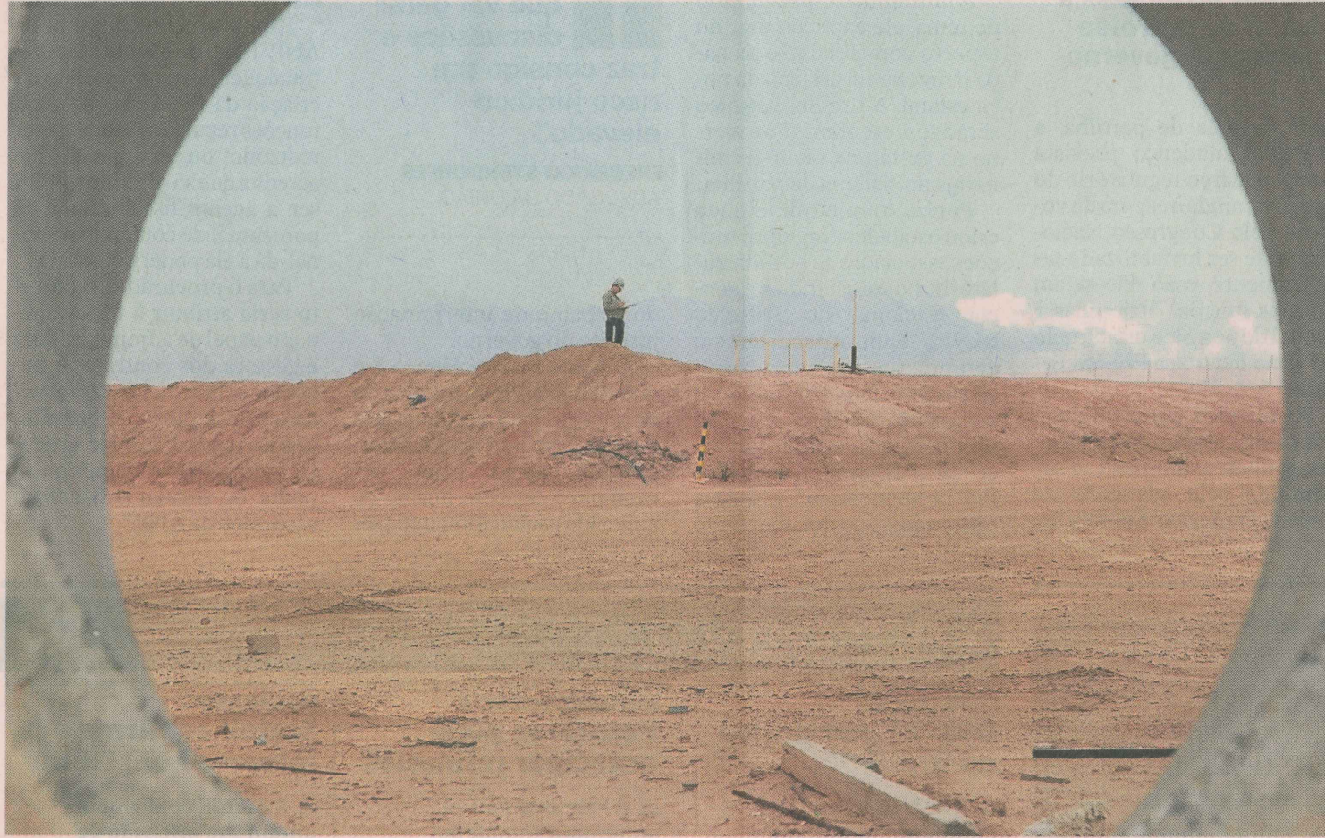
A NOVELA CONTINUA. Retomada da obra no terminal está dependendo da homologação do contrato pela Justiça
