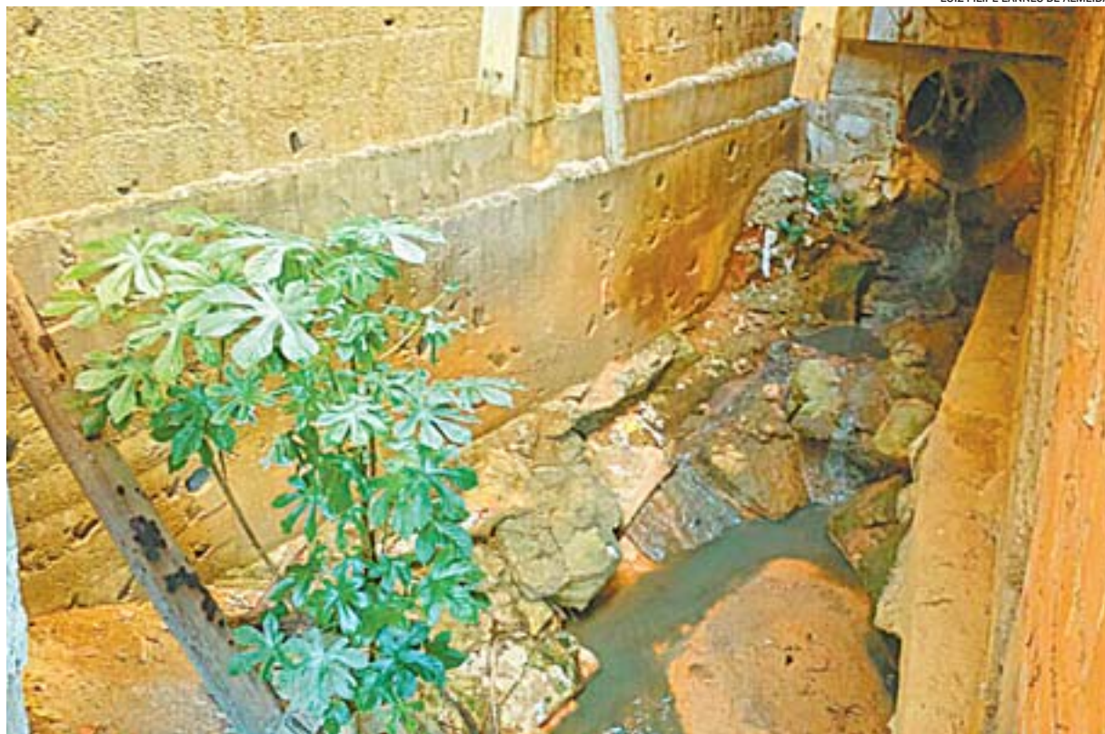
ESGOTO de residências não é tratado e é lançado diretamente em valão no bairro Universal, em Viana
