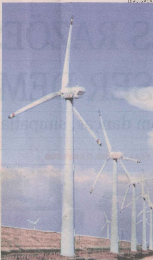
Equipamentos usam força do vento na energia eólica
