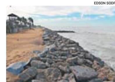
CONTENÇÃO improvisada de pedras
