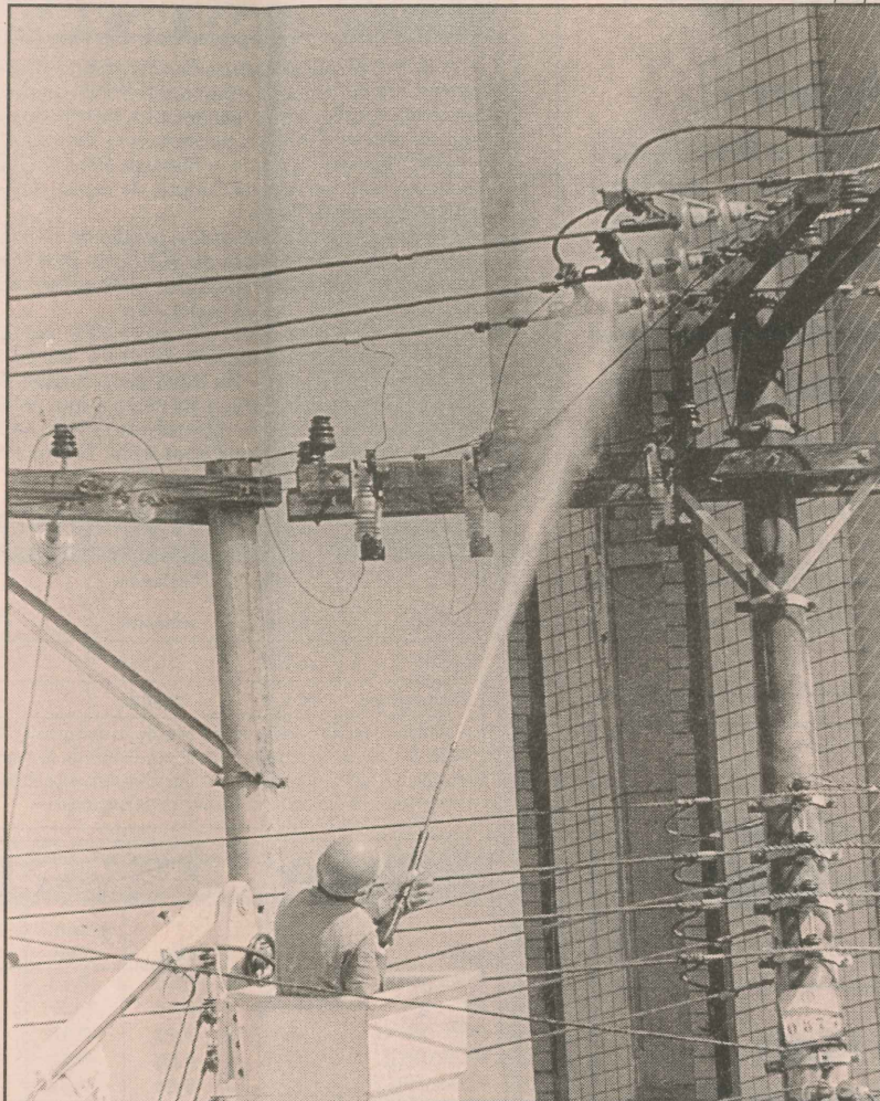
Limpeza de rede de distribuição de energia, hoje 85% importada
