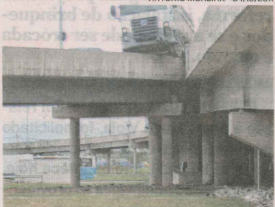
EM 2011, um caminhão subiu na mureta de proteção do viaduto, em Vila Velha.
