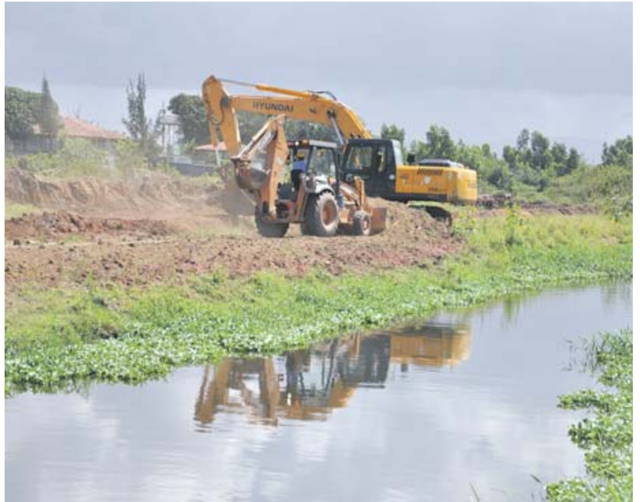
OBRAS de macrodrenagem da bacia do Congo, em Vila Velha: melhorias para evitar alagamentos no município
