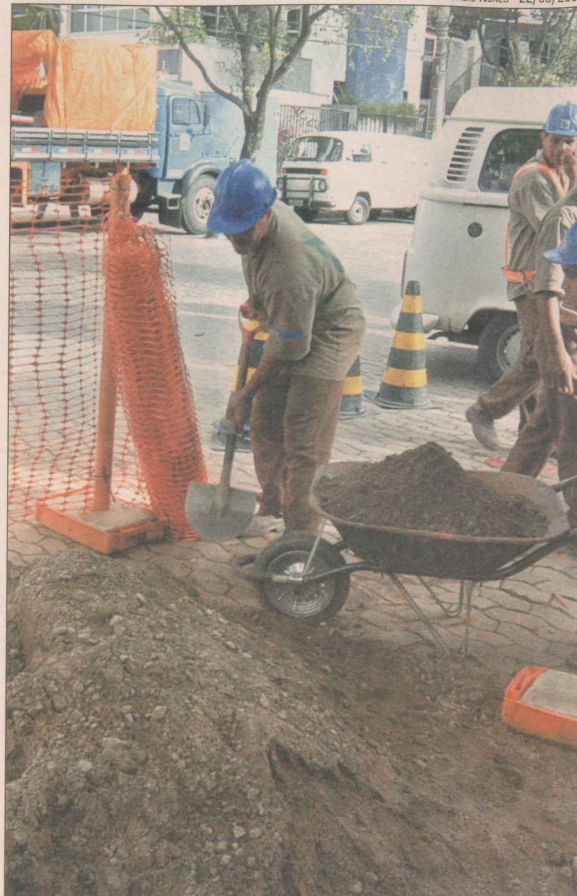
Instalação de sistema de gás: críticas para novas regras
