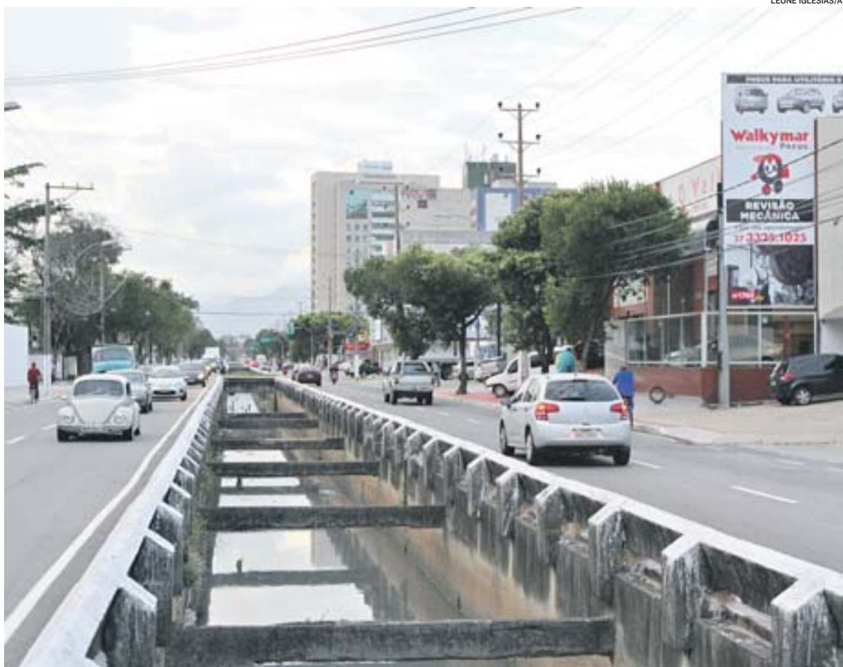
NA AVENIDA LEITÃO DA SILVA, valão será coberto. Via terá três faixas em cada sentido e nova urbanização
