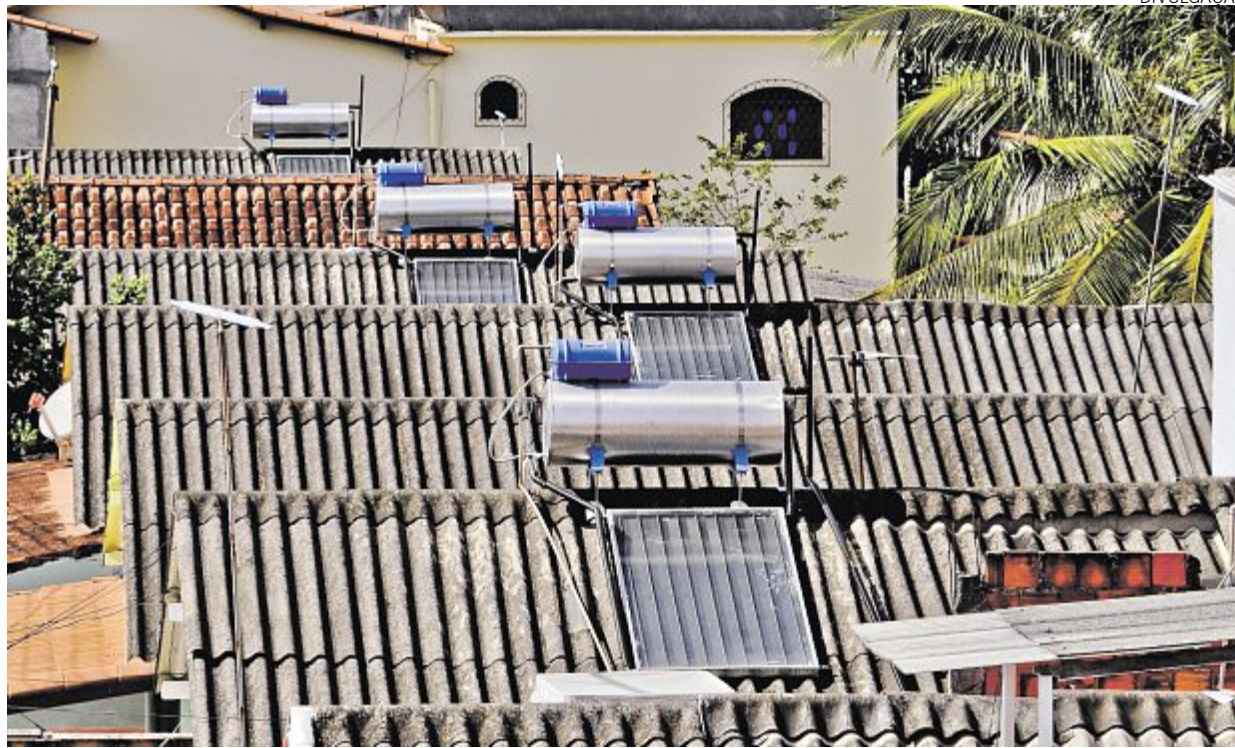
Casas captam energia solar com equipamentos de alta eficiência, em projeto que aposenta chuveiro elétrico
