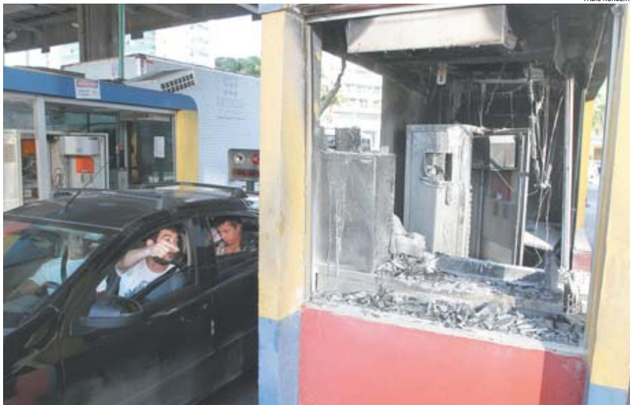
CABINE DESTRUÍDA durante protesto da última quinta-feira: sistema só voltará a operar normalmente em 15 dias
