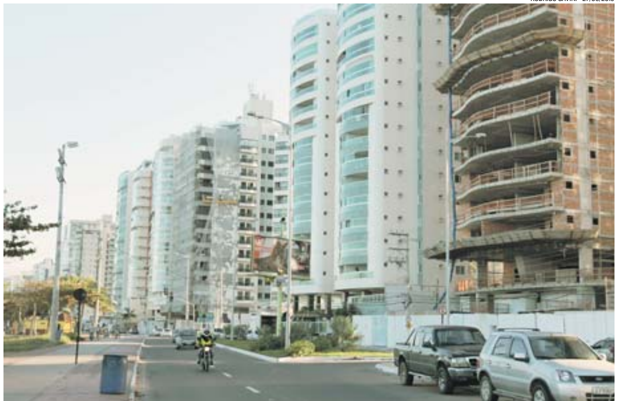
PRÉDIOS NA ORLA DE VILA VELHA: espaço destinado para áreas comuns e garagens também foi reduzido
