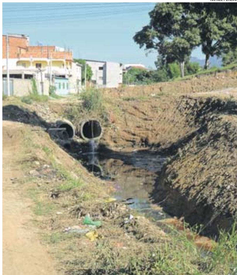
TRECHO do Córrego do Irema, em Feu Rosa, onde esgoto ainda é lançado
