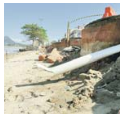
TRECHO destruído pela erosão
