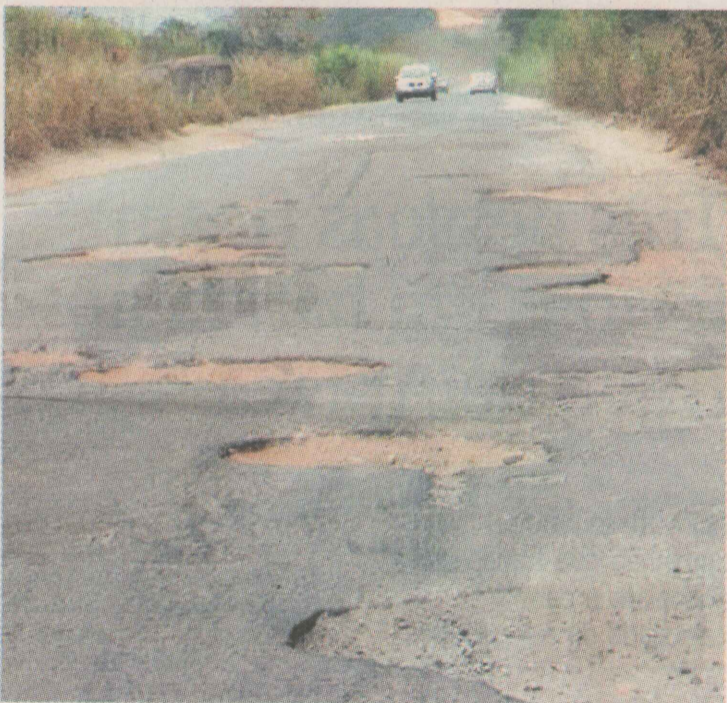
TRÁFEGO PREJUDICADO. O trecho de quatro quilômetros da Rodovia BR 259, entre Colatina e Baixo Guandu, está em péssimas condições, conforme mostram as fotos tiradas pelo leitor, que preferiu não se identificar. Como usuário da via ele pergunta: "Quando será que essa parte da rodovia será concluída?"
