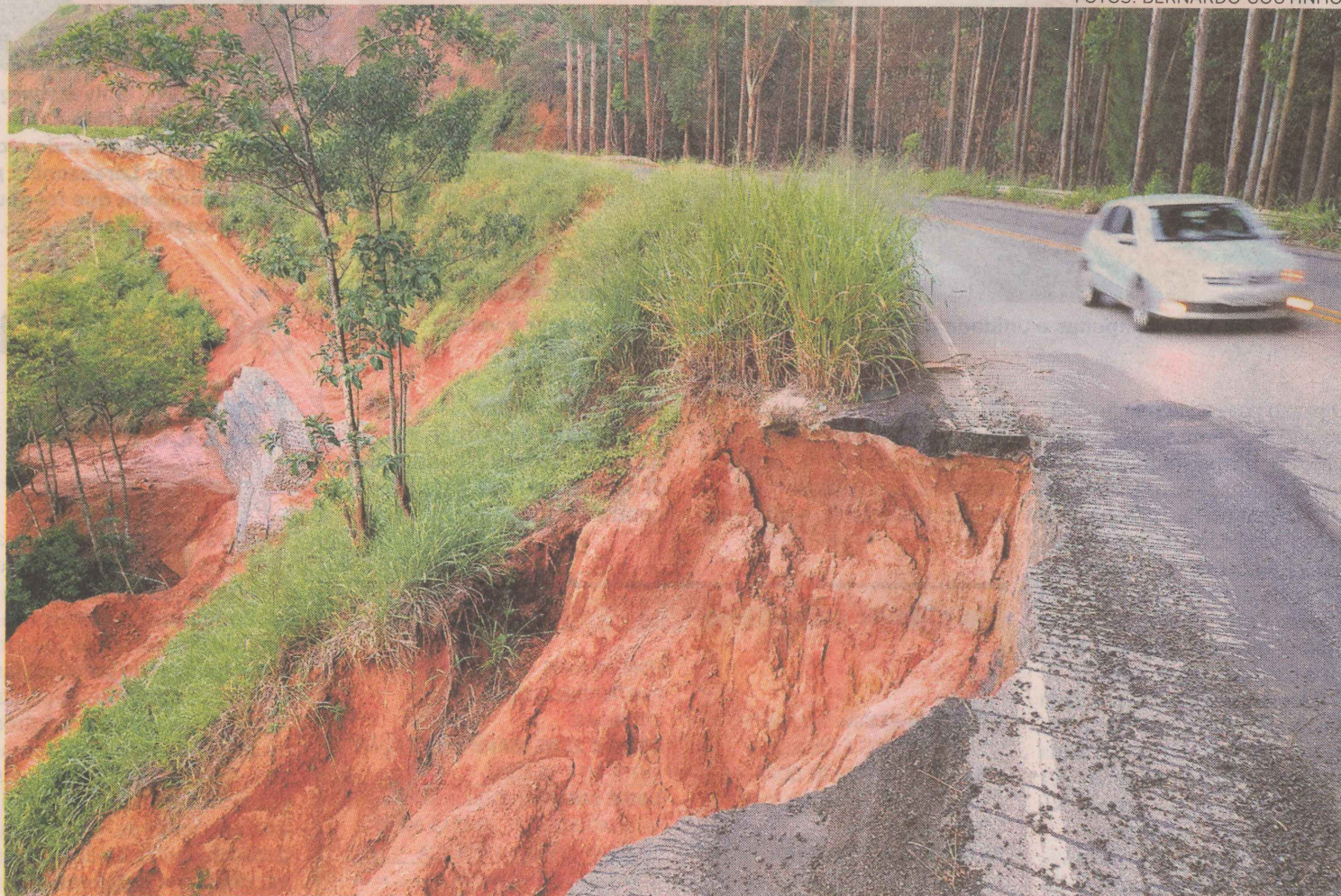
RISCO. Veículos passam bem perto da área em que asfalto cedeu, no distrito de São Lourenço, em Domingos Martins
